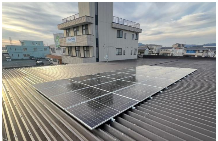
【設置した太陽光パネル】
